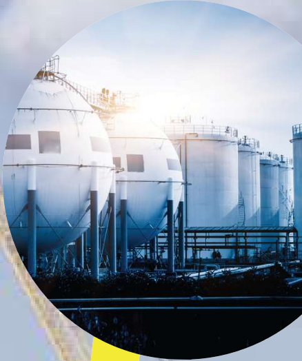
Trạm cấp khí CNG station
