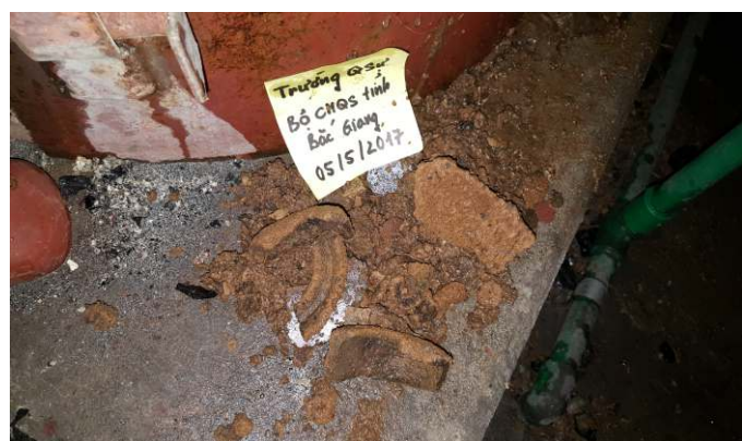
Cáu cặn bong tróc sau 1 tháng lắp máy Ewater
