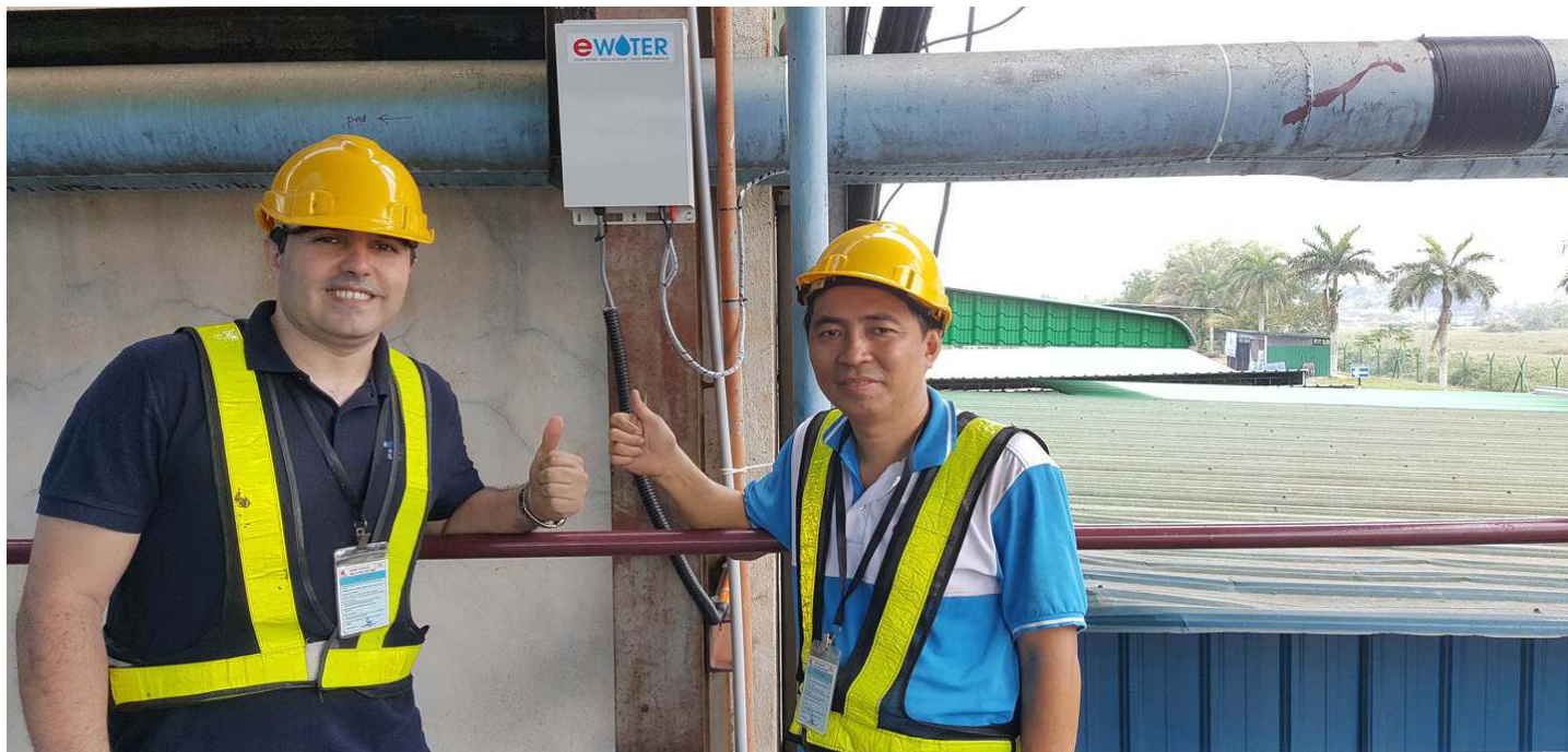
Ewater xử lý cáu cặn cho đường ống cấp nước lò hơi 30 tấn
