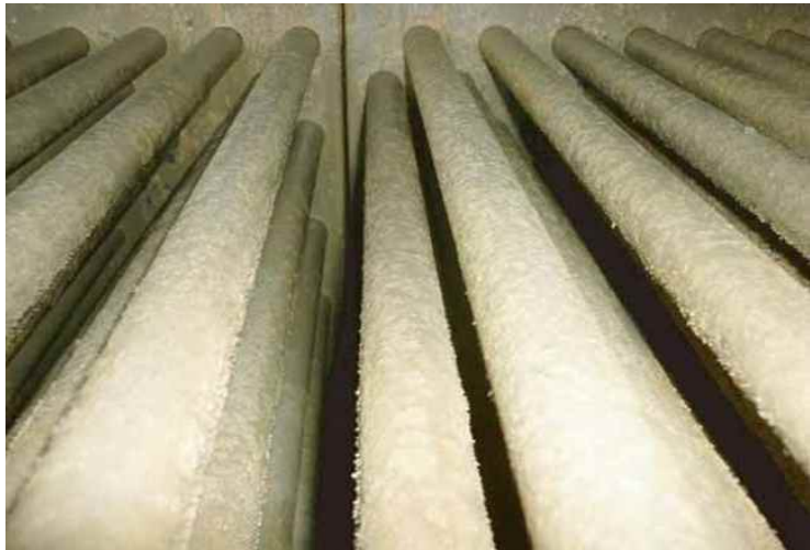
Cá cặn tại thời điểm lắp đặt.
