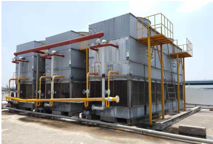
Dàn ngưng tụ bay hơi (evaporative condenser)
